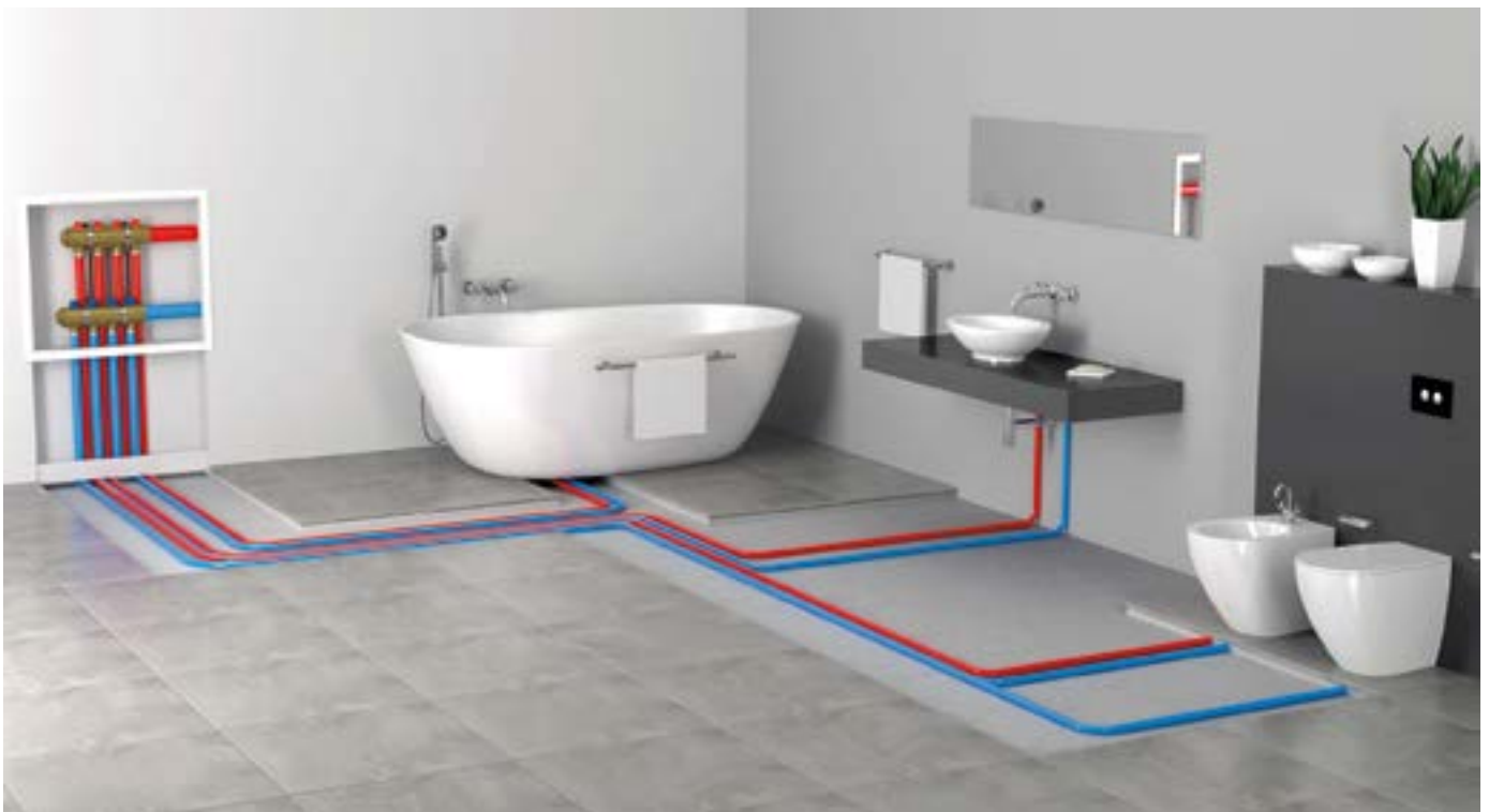
Sanitäranlage mit vorisoliertem Mehrschichtverbundrohr installiert, bzw. mit farbigen gewellten Rohr
