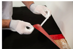
Als erstes muss eine passende Trittschalldämmung in max. 1.5 mm Stärke schwimmend verlegt werden.
